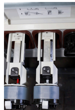
اتصال در تابلو برق داخلی، مثال:
